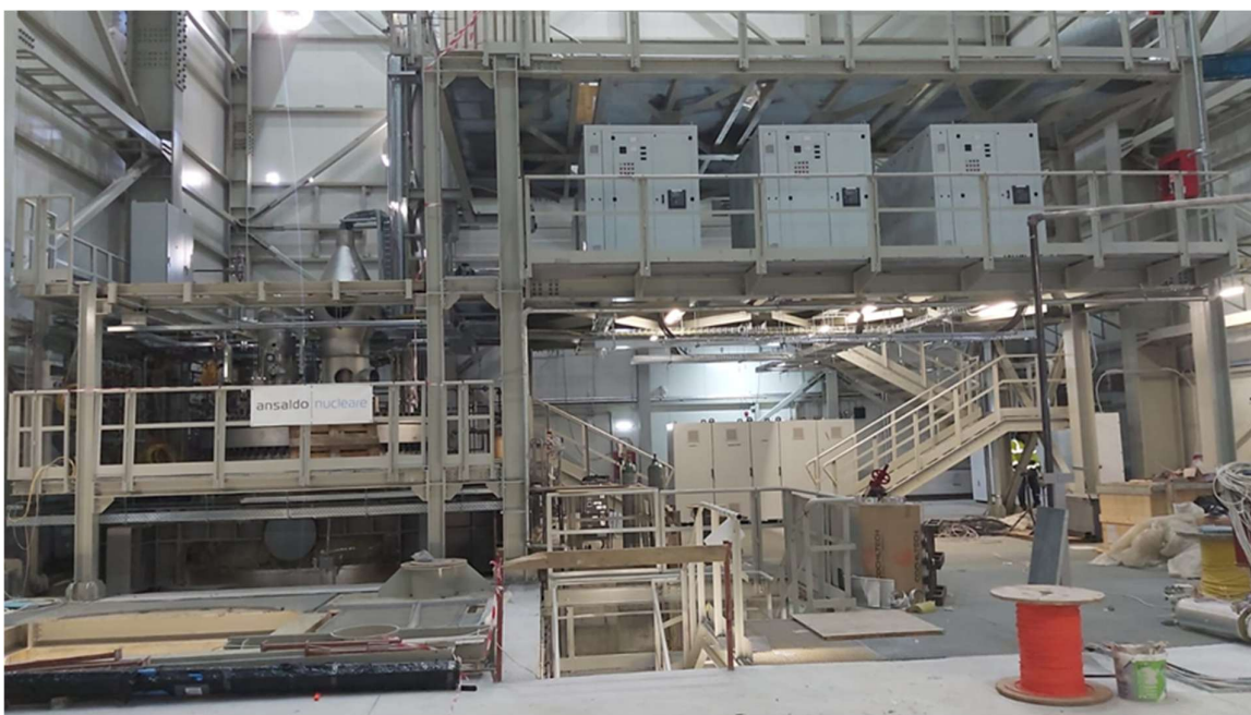
Platformă instalație Athena
